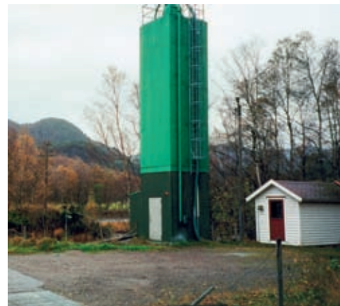
Figur 5. Kalkdoseringsanlegget i Vikedalselva ligger like oppstrøms Lokafossen, som danner en fysisk sperre for oppvandrende laks og sjøaure. Kalkmengden doseres automatisk etter pH målt i elva nedstrøms anlegget. Grunnet bedring av vannkvaliteten er doseringen av kalk redusert i de senere år.
