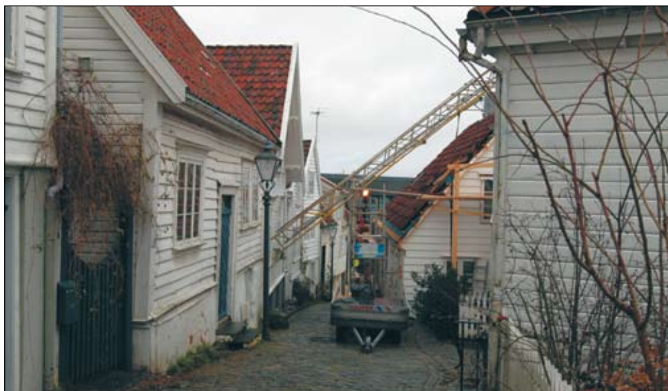
Bebyggelsen i Gamle Stavanger 2007. Hus rehabiliteres i Blidensolstredet. Foto: Siv Egeli – Byarkivet i Stavanger Houses in Gamle Stavanger 2007. A house being renovated in Blidensolstredet.
